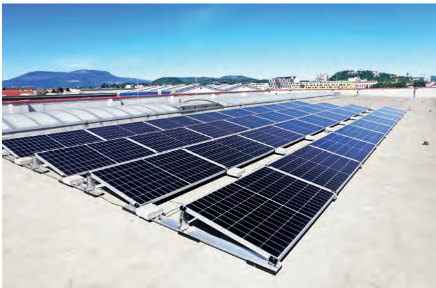
GKB-Werkstätte erhielt eine neue hochmoderne Photovoltaikanlage
